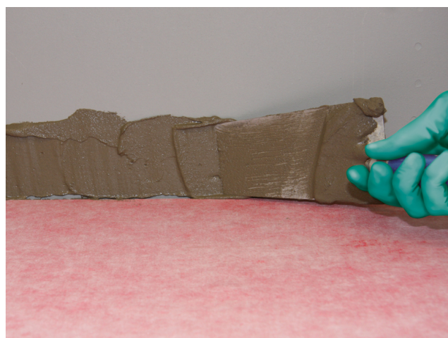
Auf den unteren Teil der Wand Sopro megaFlex S2 turbo mit einer Kelle aufspachteln.
