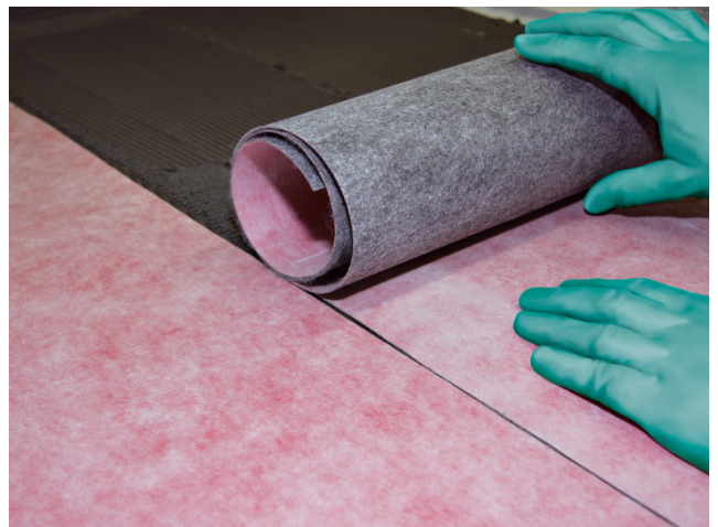
Die anschließende zweite Bahn wird stumpf stoßend an die erste Bahn verklebt.
