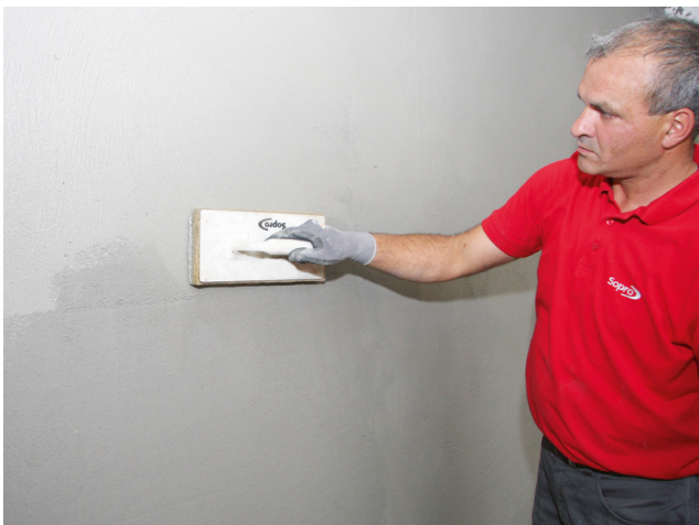
Der sauber abgezogene Putz kann nach 6 Stunden mit Fliesen belegt werden. Sollte keine Fliesenverlegung gewünscht sein, kann Sopro RAP 2® zusätzlich mit einem leicht angefeuchteten Schwammbrett ...
