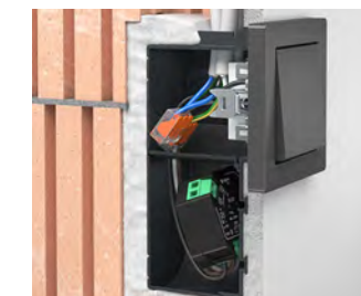
Die Installation von z. B. Funkfaktoren wird durch die Electronic-Dose komfortabel möglich, ohne dass Leitungen oder Geräte unzulässig beansprucht werden.
